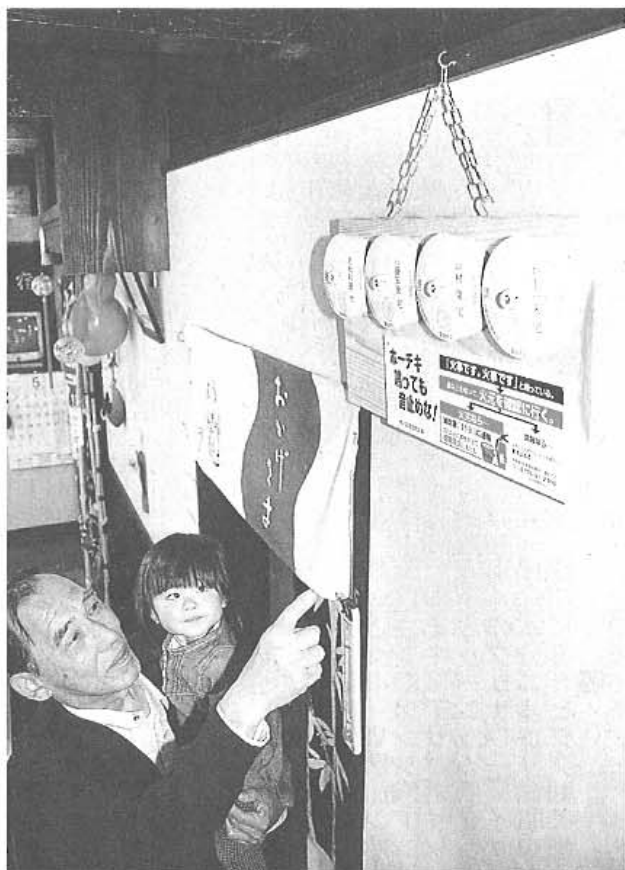
区内に整備されている近隣火災通報システムの警報機。2011年5月、若狭町熊川
